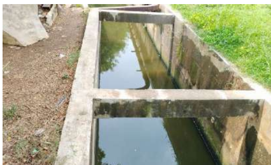
Gambar 3.2.5.71 Kondisi inlet di Waduk Elang Laut
