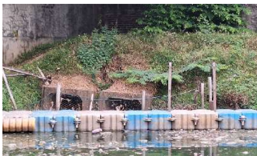
Gambar 3.2.3.82 Kondisi inlet Situ Rawa Lindung
