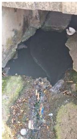
Gambar 3.2.1.17 Pintu air di inlet Waduk Hankam 2
