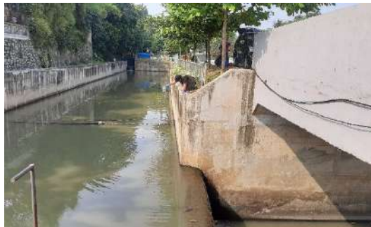
Gambar 3.2.3.88 Kondisi inlet Waduk Brigif
