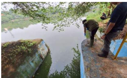
Gambar 3.2.4.36 Pintu air di inlet Waduk Cipayung
