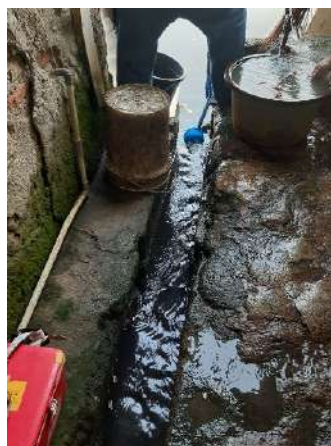
Gambar 3.2.1.48 Pintu Air di Inlet Waduk Peternakan
