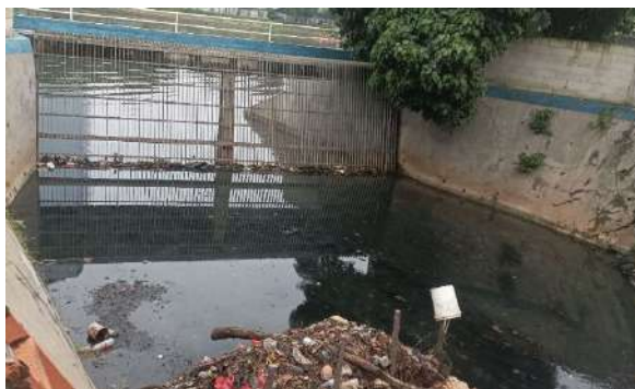
Gambar 3.2.5.6 Pintu air di inlet Situ Kodamar
