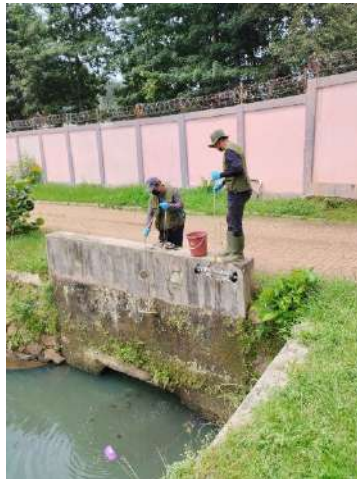
Gambar 3.2.3.44 Kondisi inlet di Situ Ragunan 3 (tidak ada aliran)
