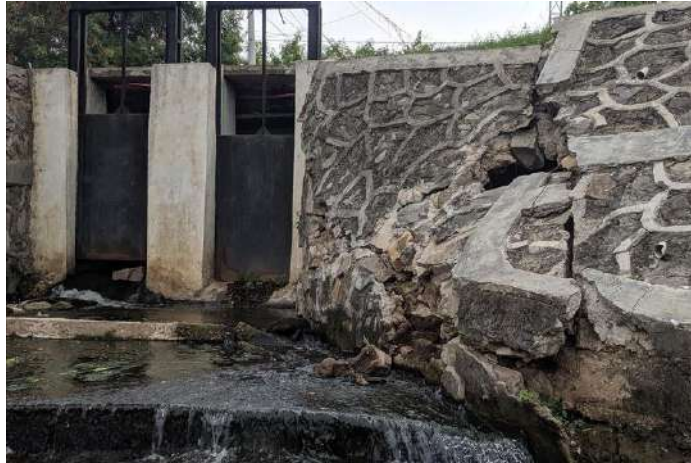
Gambar 4.6 Turap di Waduk Pluit yang hampir roboh
