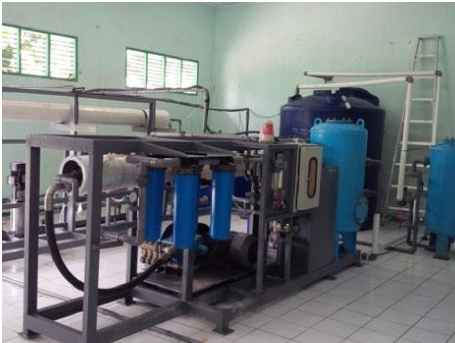
Gambar 3-21. Instalasi Sea Water Reversed Osmosis (SWRO) di Pulau Panggang, Kepulauan Seribu
